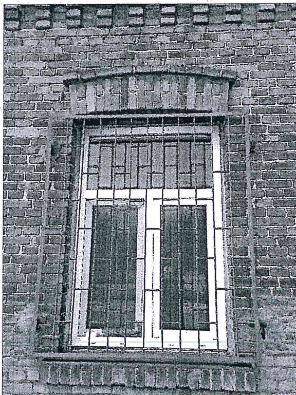
Fot. Nr 19 Detal okna na elewacji wschodniej w części południowej wysokość łuku 5 cm
