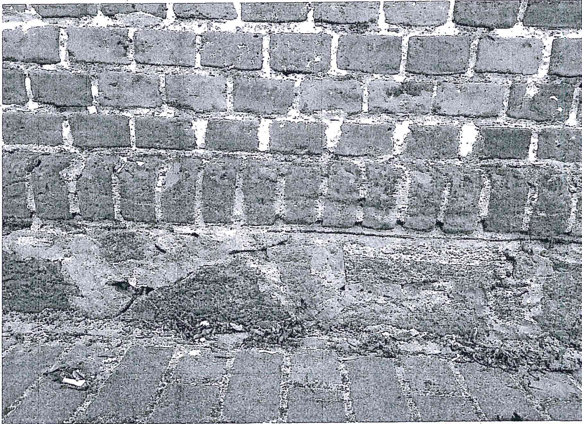
Fot. Nr 16 Ściana wsparta na kamiennym cokole zwieńczonym gzymsem z cegły ustawionej główkami na sztorc, wysuniętym przed lico ściany na 7 cm – elewacja północna,
