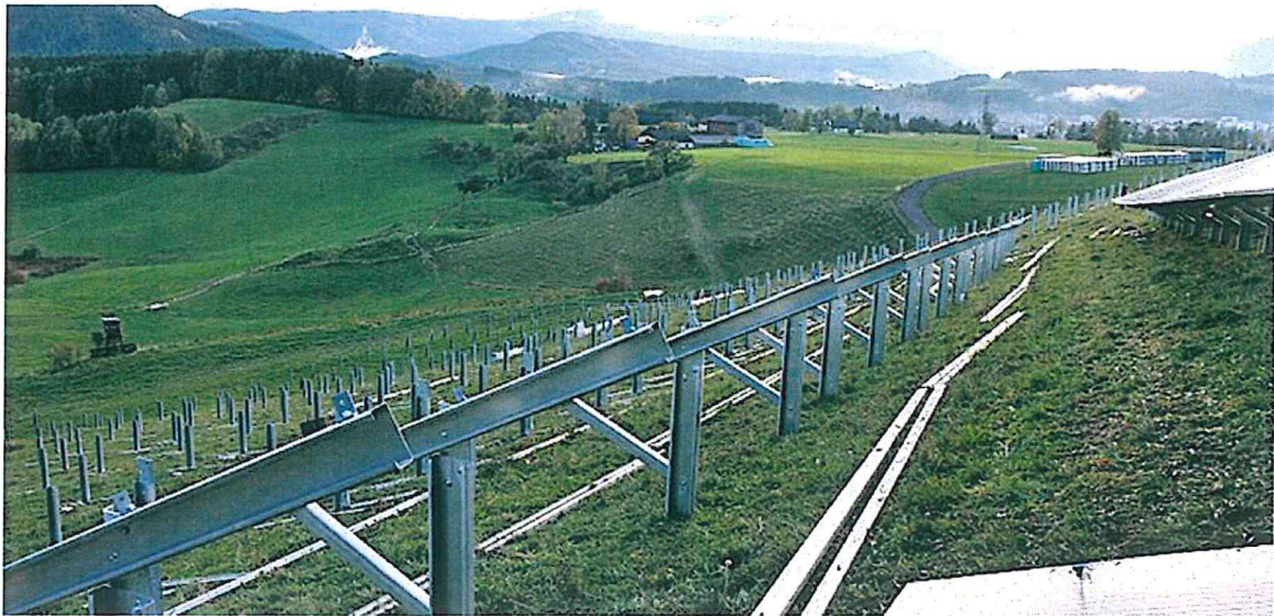
Zdjęcie 3. Konstrukcja przeznaczona do posadowienia paneli fotowoltaicznych.
