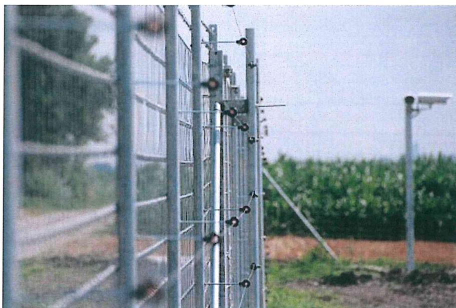
Rysunek 2. Przykładowe ogrodzenie farmy fotowoltaicznej.
