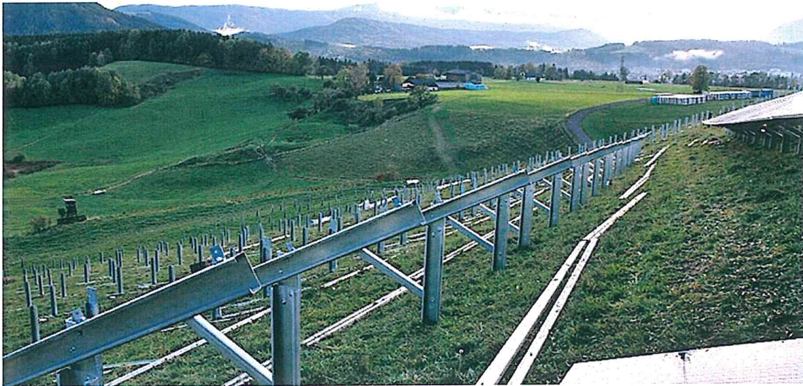
Zdjęcie 3. Konstrukcja przeznaczona do posadowienia paneli fotowoltaicznych.
