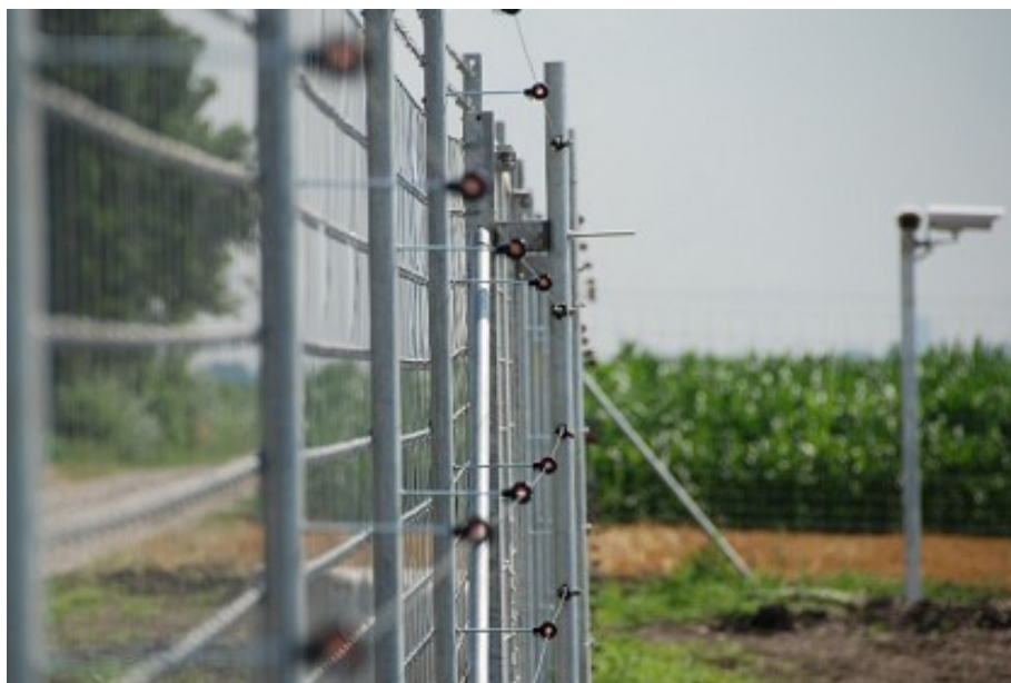
Rysunek 3. Przykładowe ogrodzenie farmy fotowoltaicznej.
