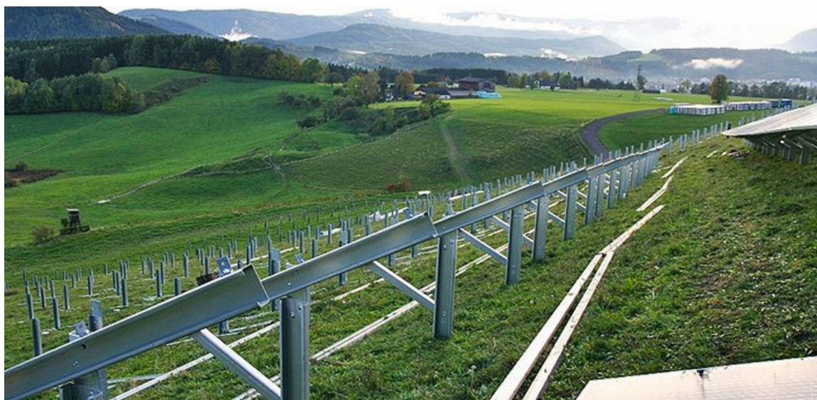
Zdjęcie 3. Konstrukcja przeznaczona do posadwienia paneli fotowoltaicznych.
