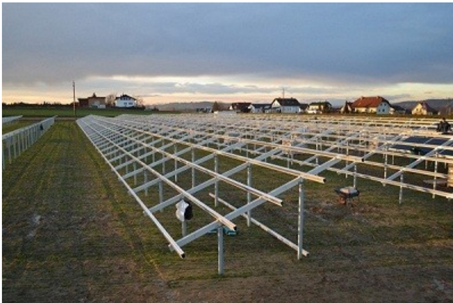
Rysunek 5. Szkielety przed montażem paneli, farma solarna NIENBURG 4 MW (Niemcy) (Remor Solar).
